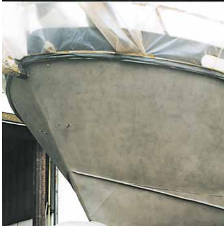
Korrodiertes Stahlrumpf vor und nach dem Strahlen
