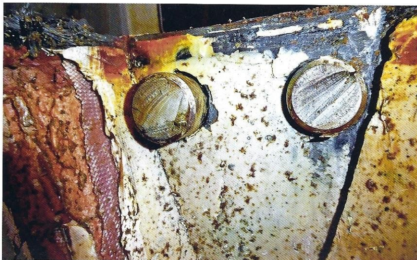
Rost um Kielbolzen.
