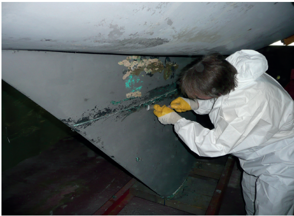
Vor dem Strahlen wird die alte Gummifuge restlos entfernt, um auch die Nahtstelle gründlich vorbereiten zu können. Sie wird im Anschluss ebenfalls gestrahlt.
