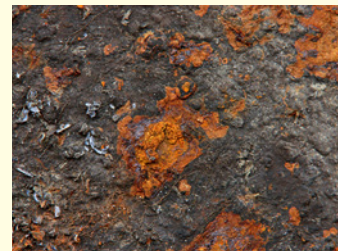
▲ Rost ist tückisch und frisst sich gerne unerkannt durch das Material nach außen
